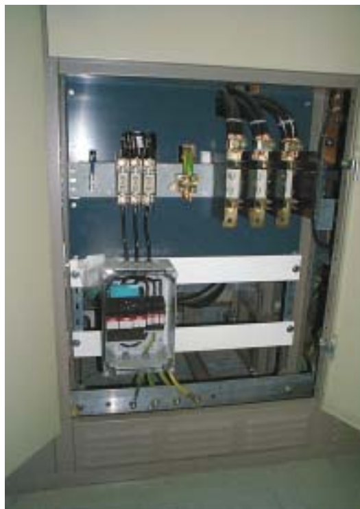
Ukkos- ja ylijännitesuojat asennettuina kennokeskukseen.
