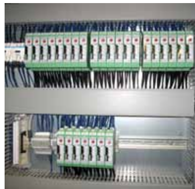
Contactronissa on 22 millimetriin saatu mahtumaan neljän kontaktorin, lämpöleean ja välireletoiminnot. Tässä asennuksessa tilansäästö on huomattava.
